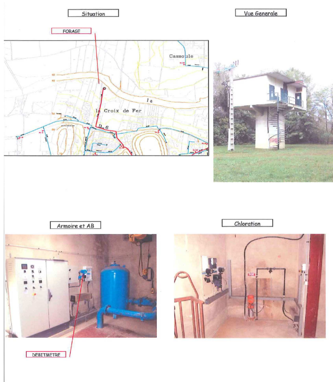
Figure 3 : Puits de la « Croix de Fer » et installation de traitement
