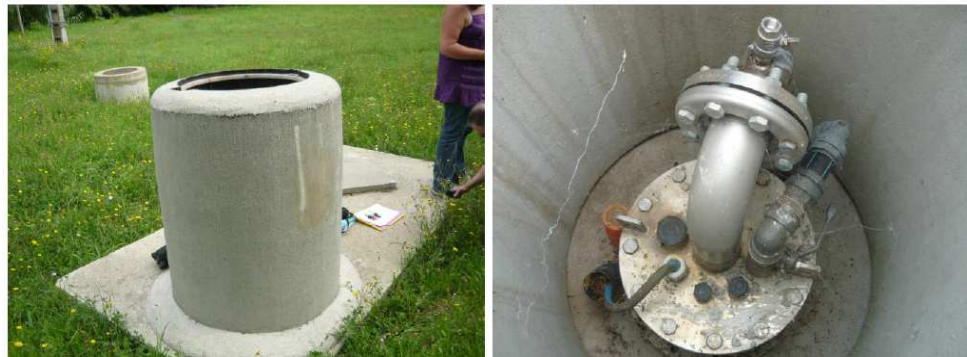
Regard d'exploitation du forage F1
