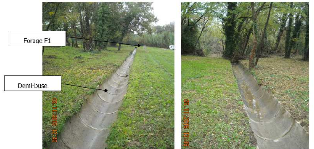
Demi buse béton traversant le PPI et
